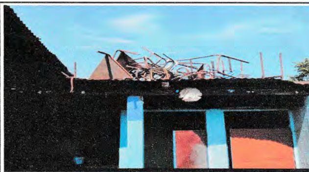
Foto 4: losa de sanitario en mal estado.
