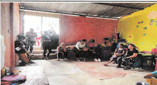
Foto 5: Piso en mal estado.
